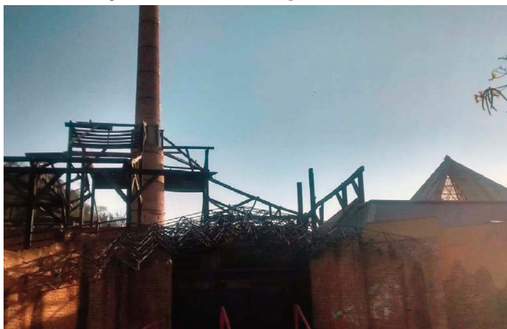
Figura 9 – Ruínas do forno após a saída da boate
