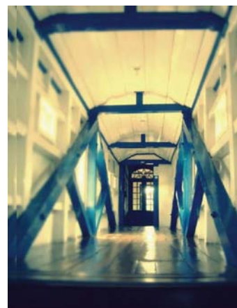
Figura 04: Vista interna do passadiço da Casa da Glória, Instituto Casa da Glória, 2015. Foto: Isabella Brandão Lara
